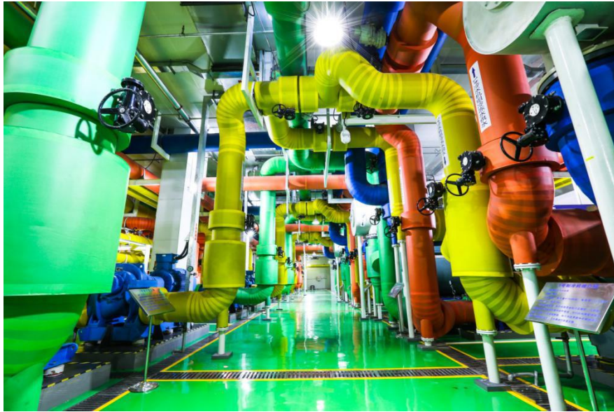
中国移动（山东济南）数据中心制冷机房
